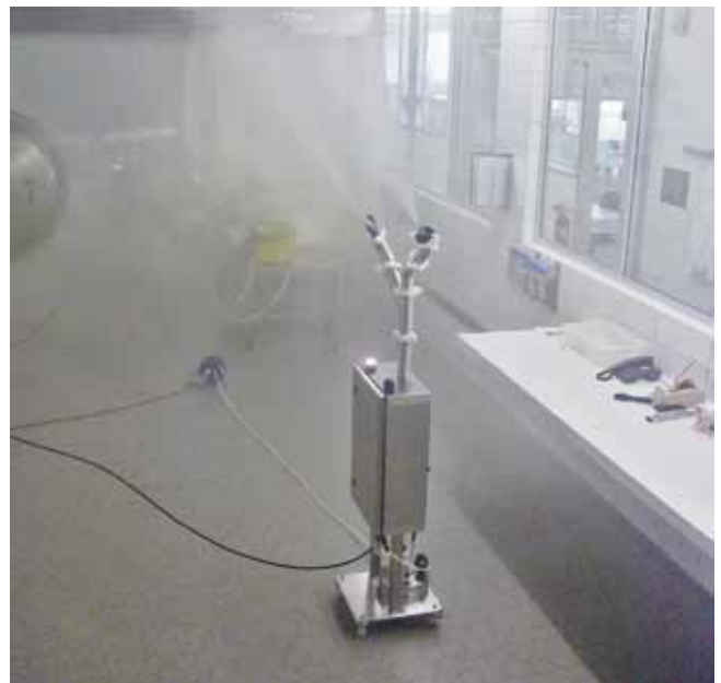
Die SolidFog-Vernebelungs-Anlage für Wasserstoff-Peroxid in einer Produktion.
