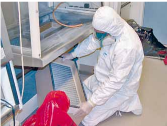
Beim Wechsel kontaminierter HEPA-Filter braucht es Sorgfalt und Arbeitsschutz.
